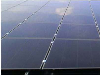
Mikromorphe Anlage - 6,375 kWp
